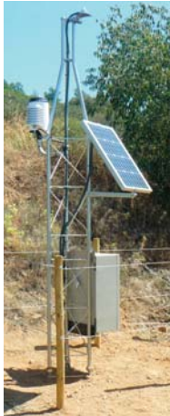
Estació automàtica per a la mesura dels paràmetres físics del sòl: Camí dels Nerets.
