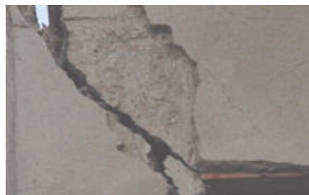
Foto 16. Detall dels danys d'un pilar.
